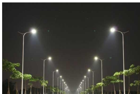
Gambar 1 Penerangan Jalan Umum Lampu jalan umum biasanya dipasang di sekitar jalan raya, jalan layang (persimpangan, overpass , fly over ), jembatan, jalan bawah tanah ( underpass , terowongan) dan jalan lain yang memerlukan penerangan [2].
